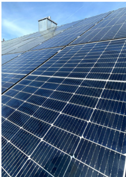
Der Strom der PV-Elemente wird in einer Batterie gepuffert. Durch die Wärmepumpe und die Heißwasserstationen ist der Eigenstromverbrauch hoch.
