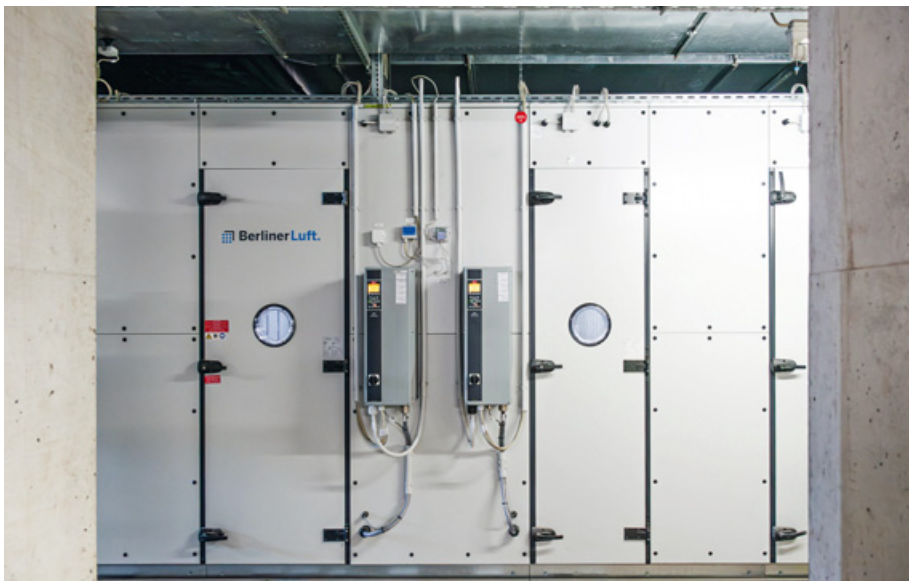
Herzstück: Die energieoptimierte RLT-Anlage aus der HygCond-Baureihe im Gebäude N260 des Biozentrums. Foto: Hürner Luft- und Umwelttechnik (HLU)
