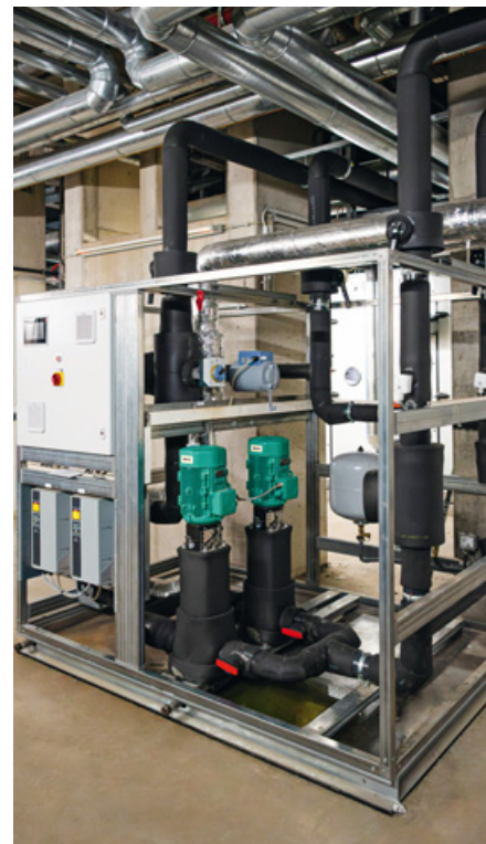
EcoCond in Vollversion: Die Wärmerückgewinnung hat nach der Sanierung einen Wirkungsgrad von mindestens 69 Prozent.
