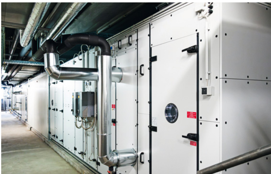
55 Prozent weniger Strom- und 60 Prozent weniger Wärmeverbrauch: Die neue RLT-Anlage ist ein Grund für die Energieeinsparung des Biozentrums. Foto: Hürner Luft- und Umwelttechnik (HLU)
