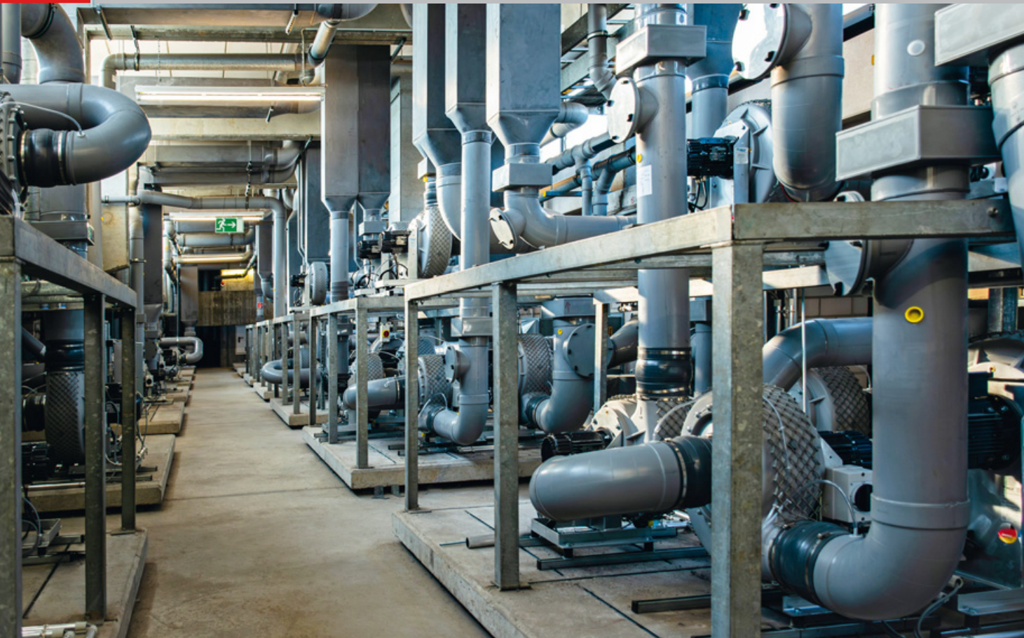
Sanierung der Sonderablüfter: Technisch optimal ausgelegte hocheffiziente Radialventilatoren mit EC-Motoren und einzigartiger Laufrad-geometrie ermöglichen einen Teillastbetrieb im Biozentrum. Foto: Hürner Luft- und Umwelttechnik (HLU)
