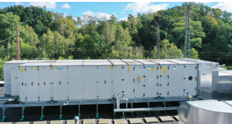
Die Belüftung und Frischluftversorgung der Innenräume erfolgt über zwei Daikin Lüftungsgeräte aus der Professional-Serie mit Wärmerückgewinnungsfunktion.
